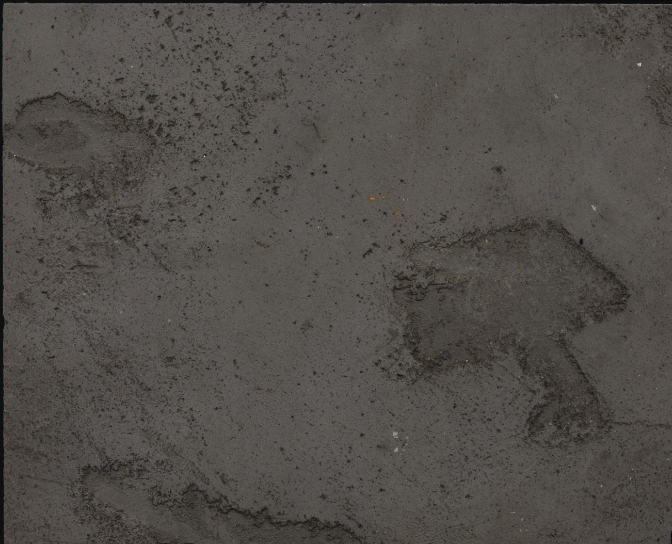
BROKEN BÉTON - OX 53
